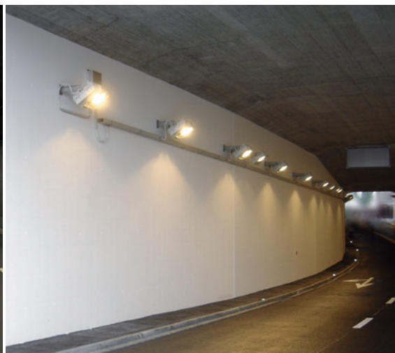
Tunel s ochrannou vrstvou společnosti MC
