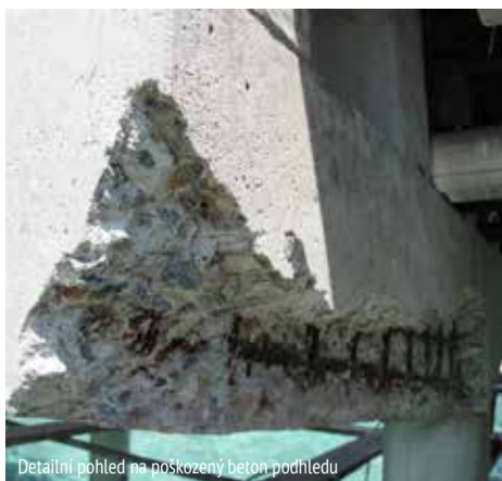
Detailní pohled na poškozený beton podhledu
